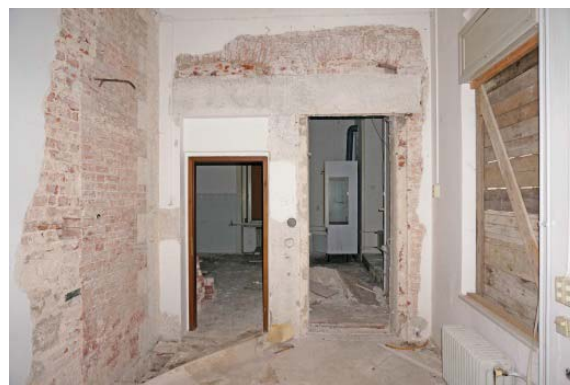
Slika 50, naknadno zazidane pravokotne odprtine
