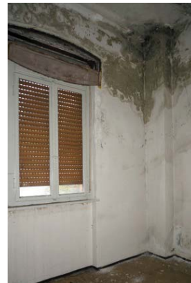
Slika 180, vdor vode na stiku med steno in stropom
