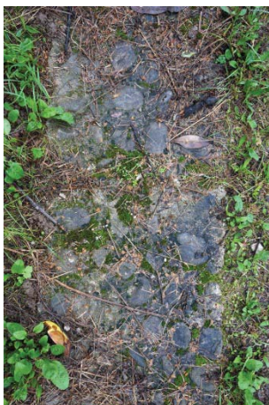
Slika 150, ostankimuld v betonski podlagi
