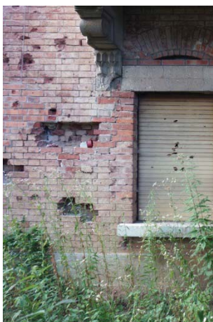
Slika 198, izguba materiala, drobljenje, strelne poškodbe, višje biološko rastje
