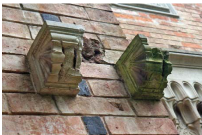
Slika 195, izguba materiala, odlom, biološke obloge, drobljenje
