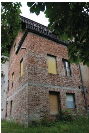
Slika 187, neprimerno pozidan JZ del stavbe
