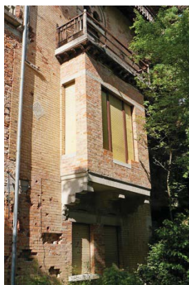
Slika 139, konzolnega balkona/izzidka ni rekonstruiral v prvotno stanje, tudi vratni odprtini spodaj je spremenil v okna
