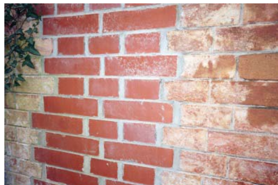
Slika 191, neprimerna rekonstrukcija, vidno izsoljevanje
