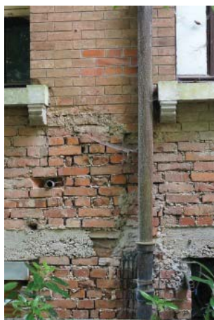
Slika 188, neprimerno rekonstruiran del vzhodne fasade
