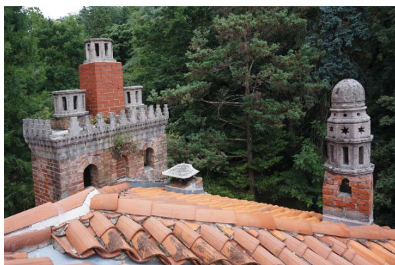
Slika 32, pogled na delno ohranjene dimnike in zračnike in neprimerne adaptacije
