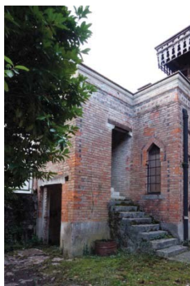
Slika 182, neprimerno zazidane odprtine, ostanki tlaka ob vratih
