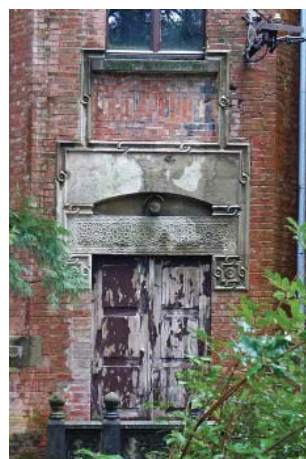
Slika 194, poškodbe zaradi vdora vode (streha), izguba barvnih plasti
