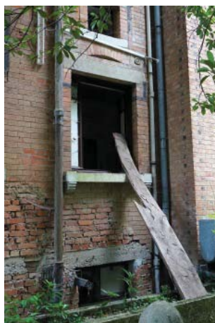
Slika 199, neprimerna rekonstrukcija, vandalizem
