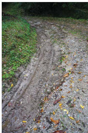
Slika 151, poškodbe makadamske poti
