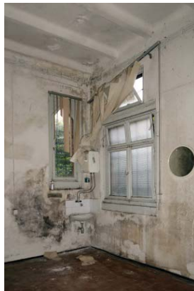
Slika 179, vdor vode ob okenskih odprtinah
