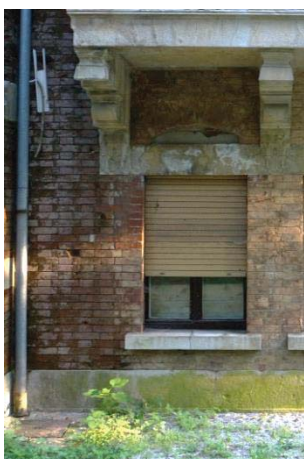
Slika 192, prelom police, izsoljevanje, biološke obloge, strelne poškodbe
