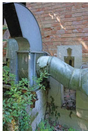
Slika 189, neprimerno postavljena cev
