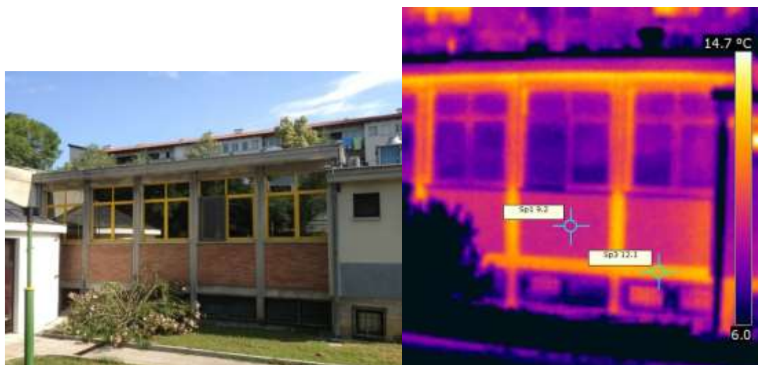
Slika 26: Toplotni mostovi pri vходу v telovadnico (južna fasada) (Centralni vrtec) (Razširjenem energetske pregledu Centralnega vrtca, 2012)
