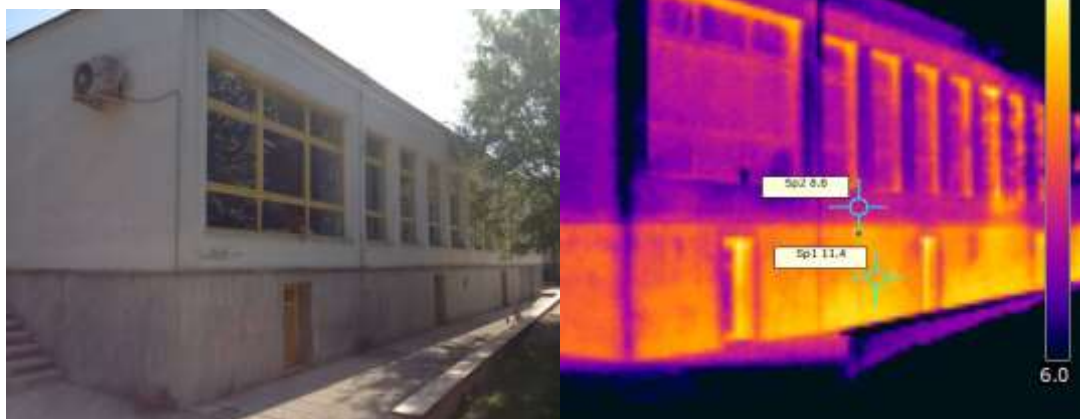
Slika 25: Toplotni mostovi na novejšem delu vrtca (južna fasada) (Centralni vrtec) (Razširjenem energetske pregledu Centralnega vrtca, 2012)
