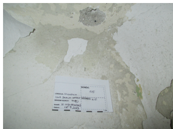
S5 na Z steni in stropu.
