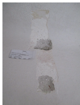
S10 na Z steni in stropu.
